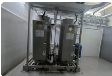
▲ 改造后的容积式汽水热交换器
